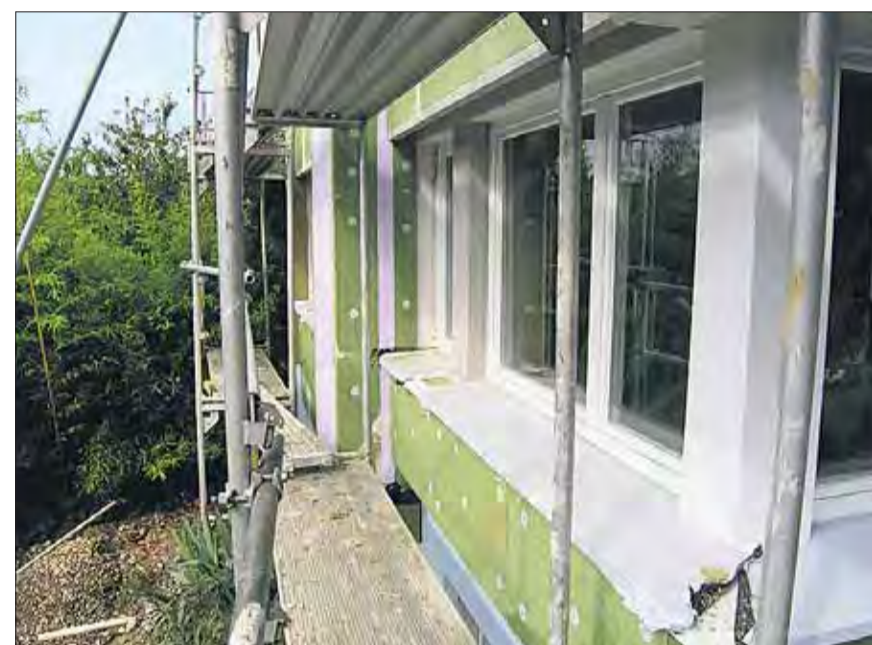
Dass in bestehenden Gebäuden ein grosses Energie- und Kostensparpotenzial liegt, ist vielen Hausbesitzern bewusst. Die Nachfrage nach Fördergeldern war in keinem Bereich so gross wie bei den Gebäudesanierungen.
