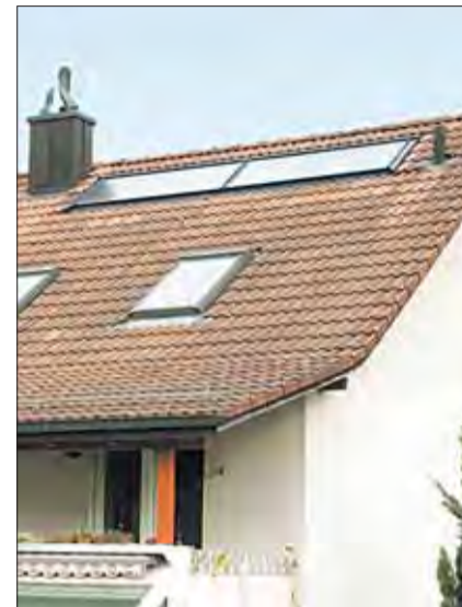
17.00 Uhr: Nach nur einem Tag ist die Solaranlage für Warmwasser samt dem Speicher montiert.
